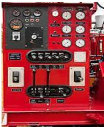
Preventorun əsas idarəetmə pultu Основной пульт управления превенторами Main preventer control panel
